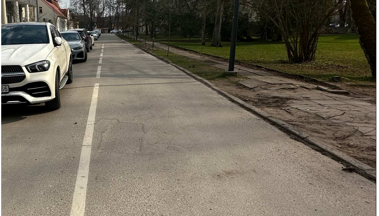
4 pav. Projektuojamos Gudobelių alėjos gatvės bortų būklė
