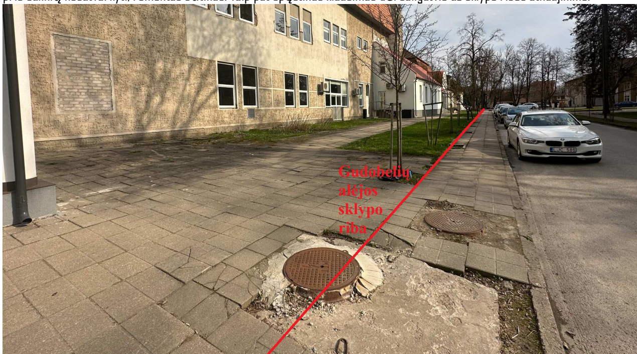
6 pav. Projektuojamos Gudobelių alėjos šaligatvio būklė iš pašto pusės.
