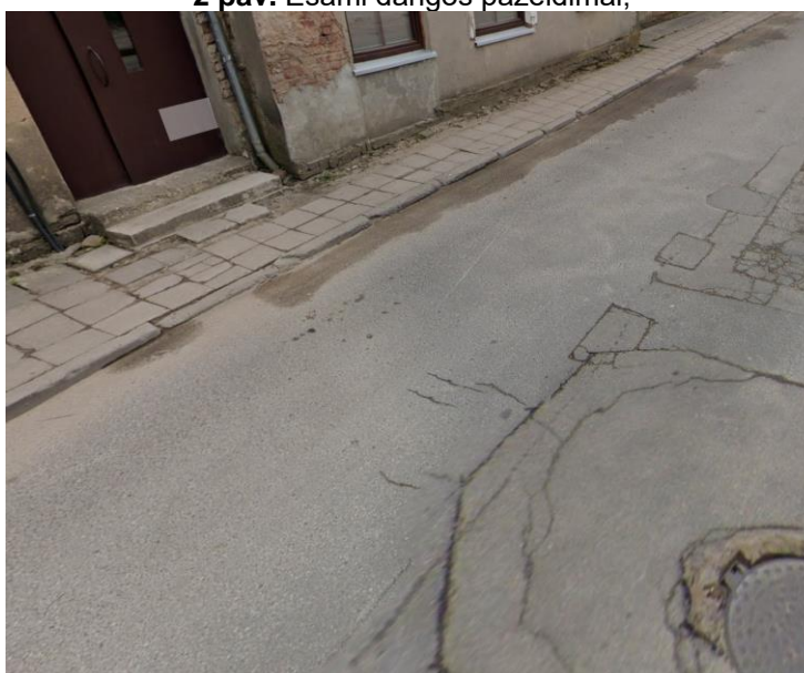
3 pav. Esami dangos pažeidimas, neužtikrinamas paviršinio vandens nuvedimas. Bendrai tiriamo ruožo reljefas yra mažai kintantis.
