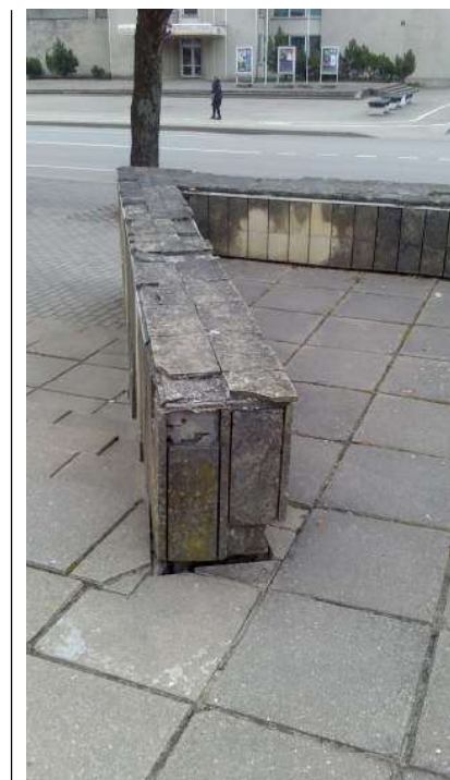
Atraminės sienelės architektūrinė funkcija neaiški, pati sienelė nusidėvėjusi
